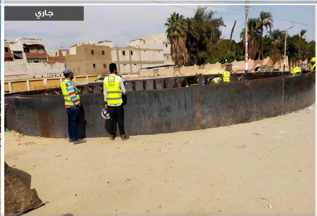
محطة رفع صرف صحي المنيا
