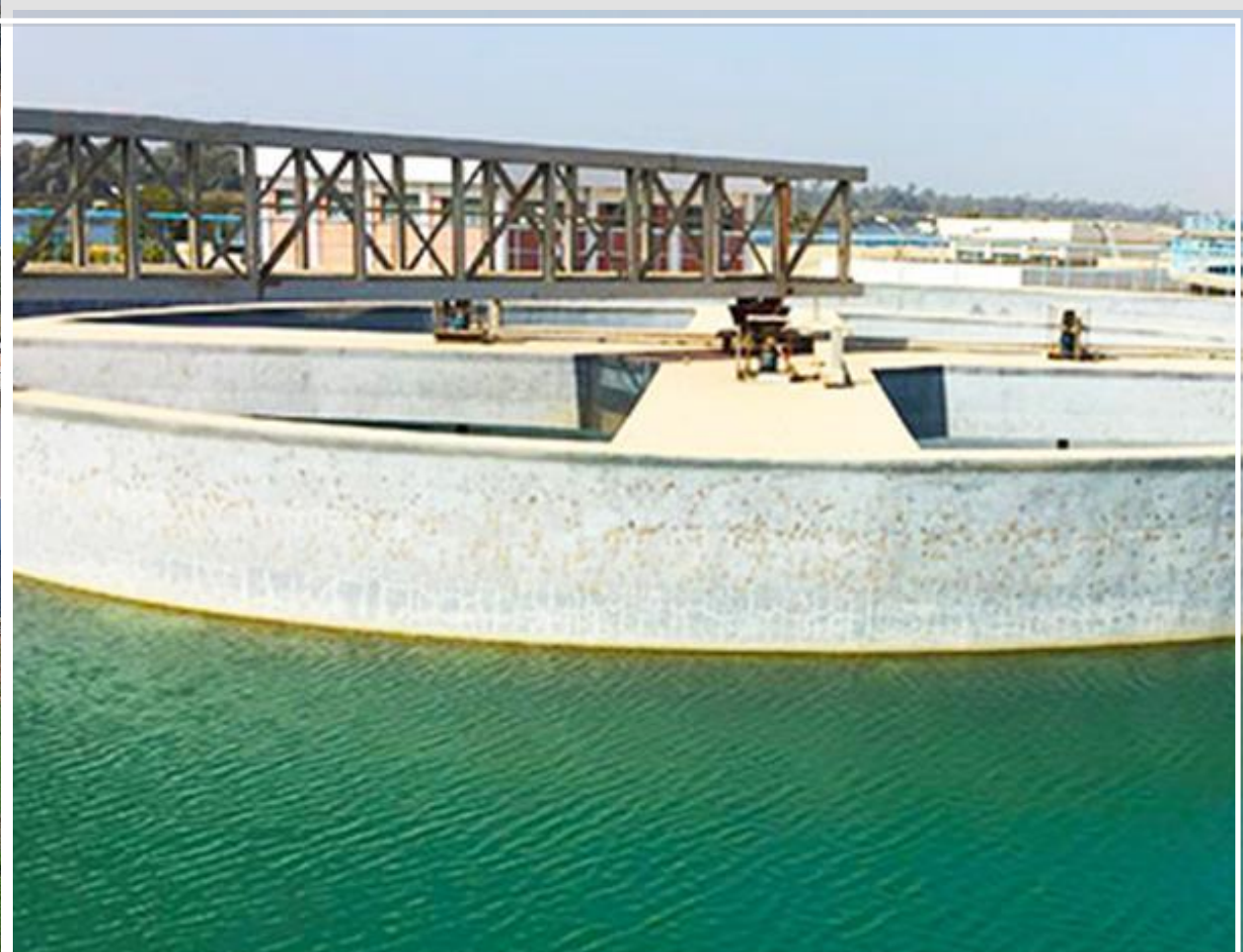
محطة تنقية مياه دار السلام - محافظة سوهاج
